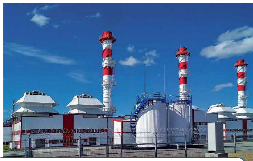
Фото 1. Энергоцентр «Уса» – ГТУ-ТЭЦ электрической мощностью 100 МВт
