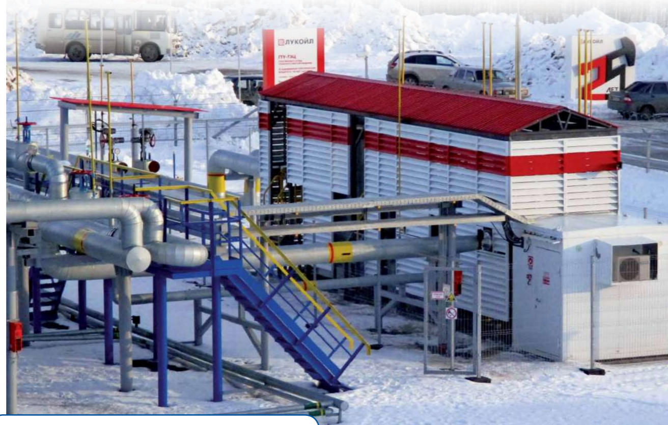
Фото 3. Блок подготовки попутного газа «ЭНЕРГАЗ»
