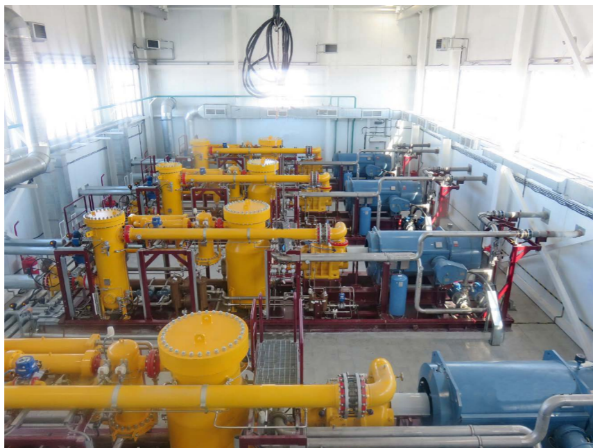
ФОТО 6. Компрессорная станция внутрицехового типа для ГТЭС Восточно-Мессояхского месторождения
