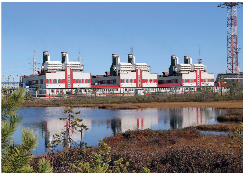
ФОТО 3. ГТЭС Ватьеганского месторождения работает на попутном газе
