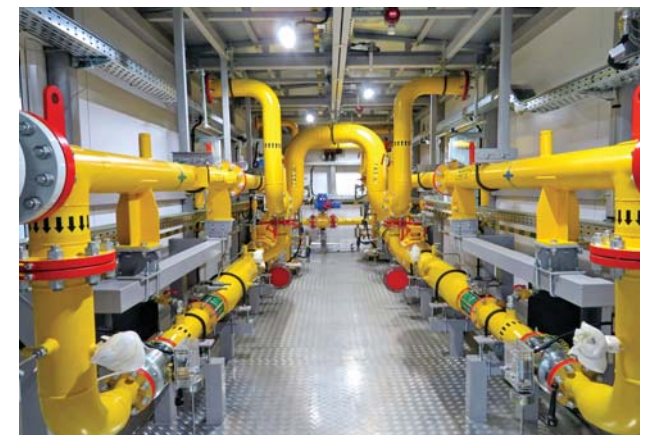
Фото 13. Газорегуляторный пункт обеспечит топливом печи прямого нагрева нефти на УПН «Уса-Тяжелая нефть»
