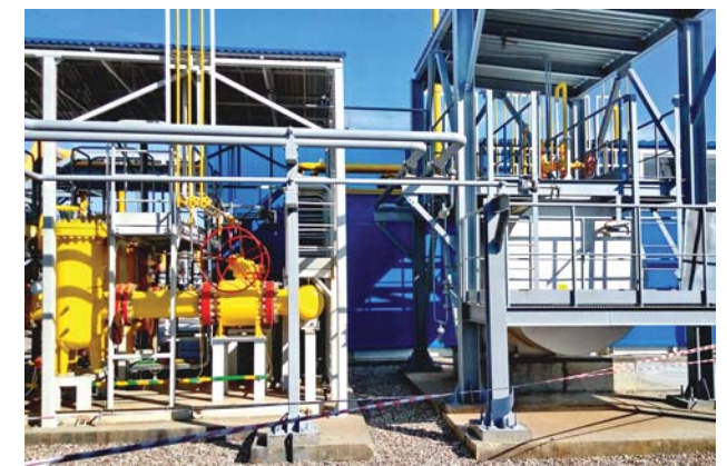
Фото 3. Внешний блок предварительной фильтрации и узел дренажа конденсата
