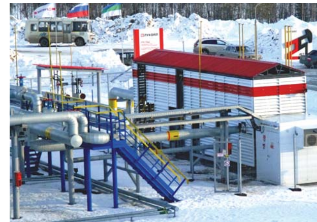
Фото 10. Блок подготовки попутного газа для ГТУ-ТЭЦ Усинского месторождения ЛУКОЙЛ-Коми
