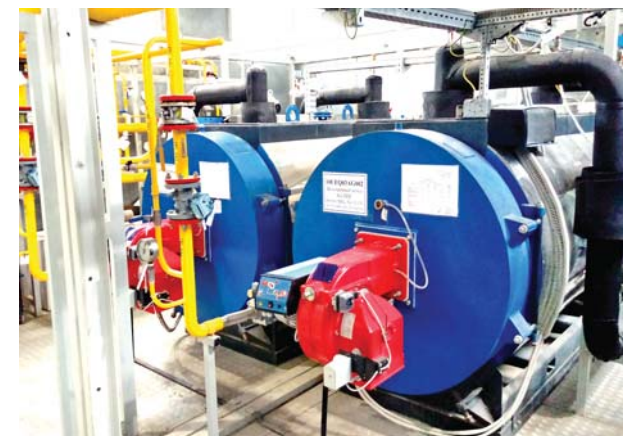
Фото 7. Отсек блочной котельной встроены в общий технологический модуль
