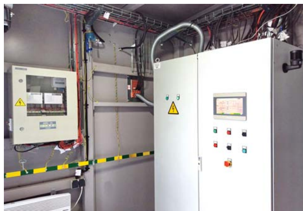
Фото 5. Отсек САУ комплектной установки
