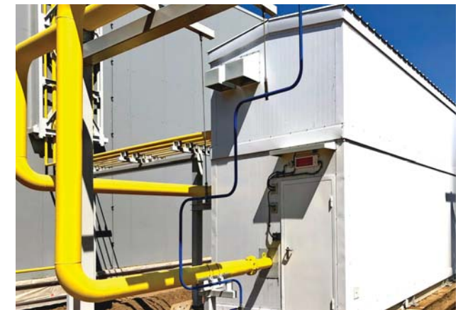
Фото 11. Блочный пункт очистки газа для ГТУ-ТЭС в Елабуге – компактная установка в базовой комплектации
