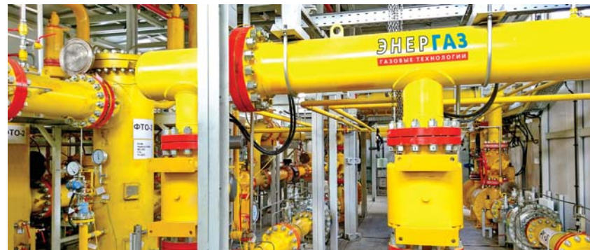
Фото 1. Пункт подготовки газа для парогазовых энергоблоков стратегически важной Прегольской ТЭС
