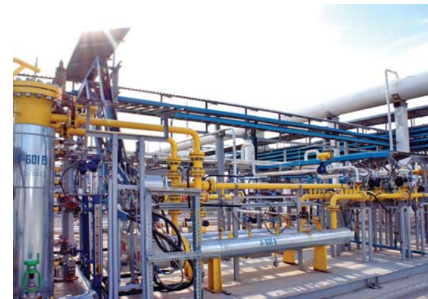
Фото 6. Система газоподготовки для ДКС «Алан» (Узбекистан). Здесь применены электрические подогреватели газа
