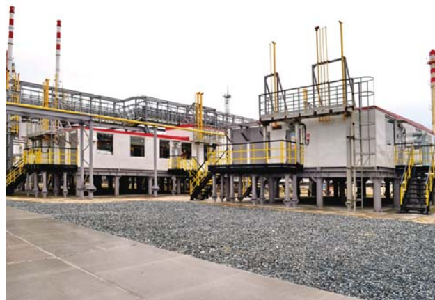
Фото 8. Установка подготовки топливного газа для объектов УКПГиК на Восточном Уренгое – основной (слева) и резервный модули
