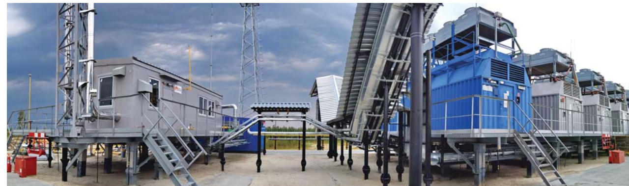
Фото 12. УПТГ «ЭНЕРГАЗ» (слева) в составе газопоршневой электростанции Барсуковского месторождения Роснефти
