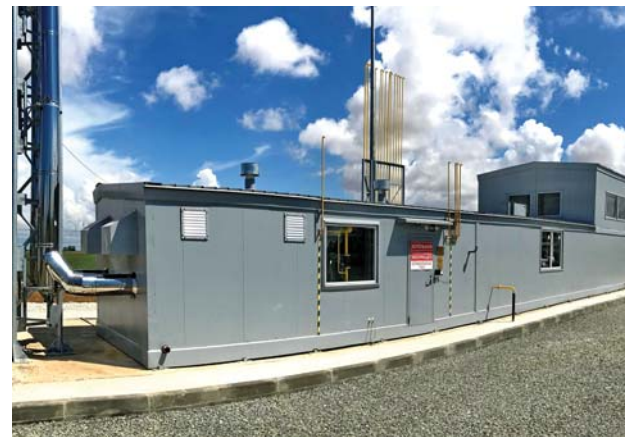
Фото 9. Автоматизированная газораспределительная станция производства ГК ЭНЕРГАЗ
