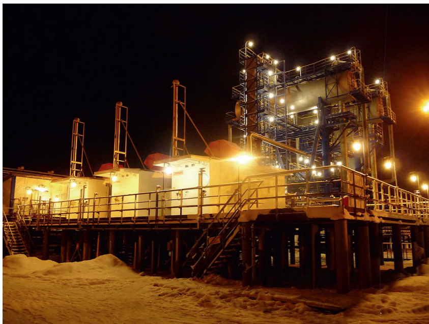
ДКС низкого давления на базе установок Enerproject перекачивает низконапорный ПНГ на Варандейском месторождении ЛУКОЙЛ-Коми
