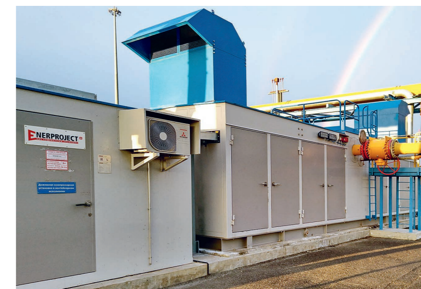
Самые мощные в России винтовые компрессорные установки Enerproject обеспечивают топливным газом турбины Грозненской ТЭС
