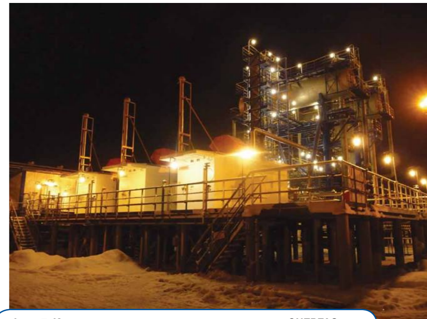
Фото 7. Компрессорная станция низкого давления «ЭНЕРГАЗ» надежно работает в условиях Заполярья (Варандейское месторождение в Ненецком АО)
