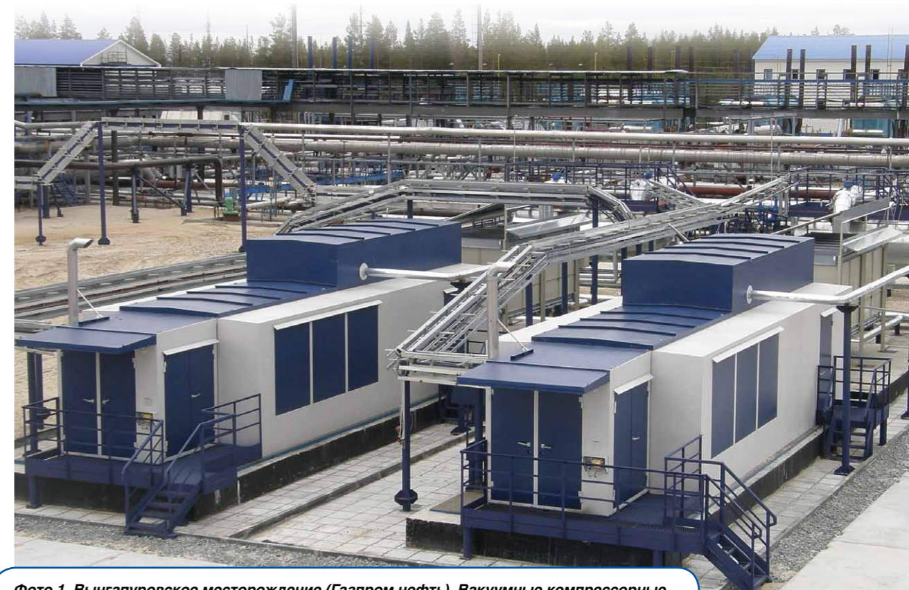
Фото 1. Вынгапуровское месторождение (Газпром нефть). Вакуумные компрессорные установки «ЭНЕРГАЗ», спроектированные для низконапорного ПНГ (0,001 МПа)
