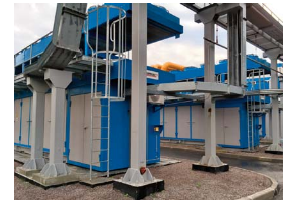
Фото 1. ДКС топливного газа для ГТУ-ТЭЦ Центральной ТЭЦ С.-Петербурга
