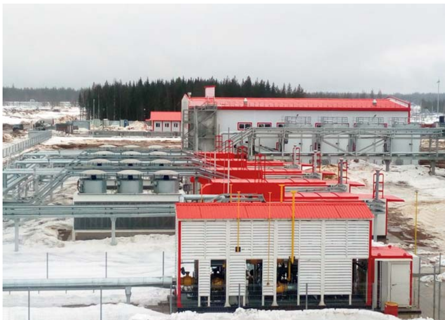
Фото 8. Система газоподготовки и газоснабжения энергоцентра «Ярега»
