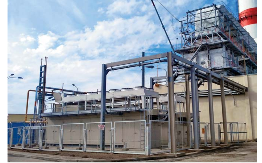
ГТУ-ТЭЦ на Ярегском месторождении – энергоцентр «Ярега» («Лукойл-Коми»)
