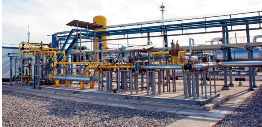
Фото 7. Система подготовки топливного и пускового газа для газо-перекачивающих агрегатов ДКС «Алан»
