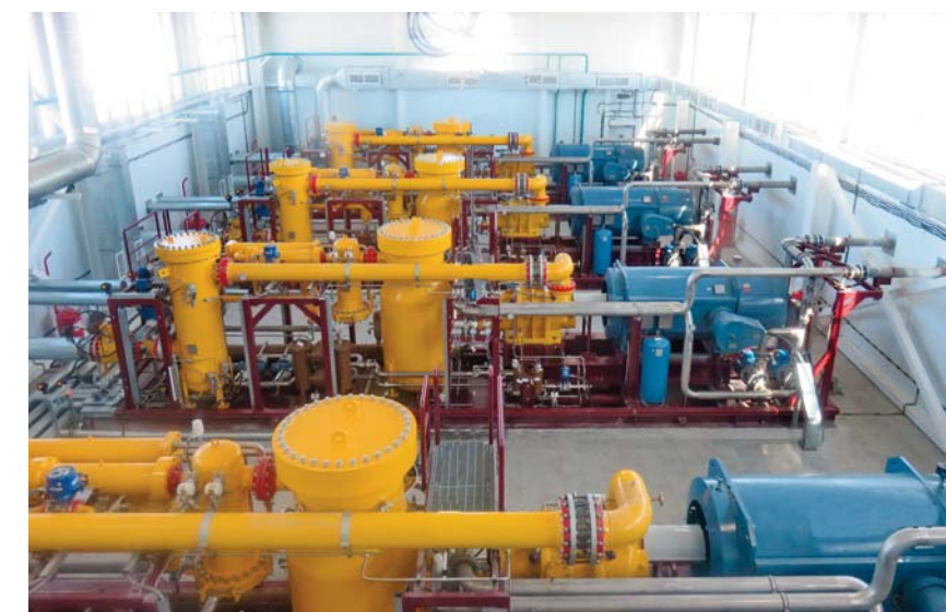
Фото 2. Установка подготовки топливного газа для ГТЭС Восточно-Мессояхского месторождения
