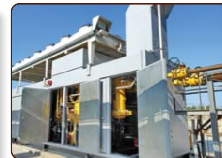
Рис. 4. Дожимная компрессорная установка для парогазовой электростанции ПАО «Мордовцемент»
