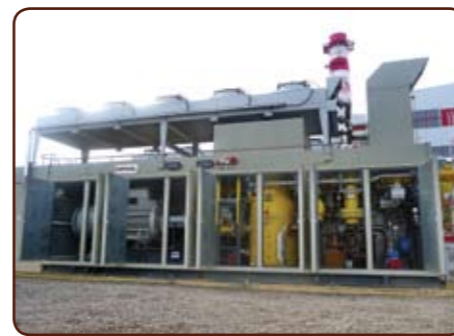
Рис. 8. Оборудование для подготовки и подачи топливного газа в турбины Буденновской ПГУ-ТЭС
