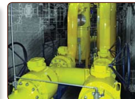
Рис. 10. Технологический отсек блочного пункта подготовки газа
