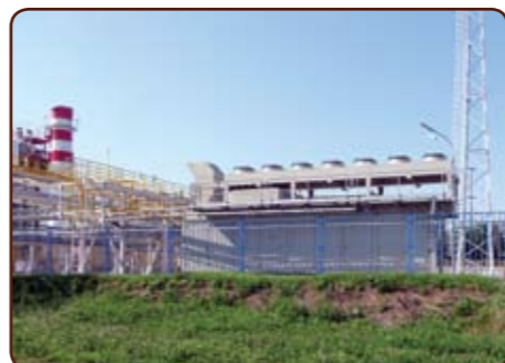
Рис. 7. ДКС «ЭНЕРГАЗ» в контейнерном исполнении действует в составе заводской ГТЭС АО «Апатит»
