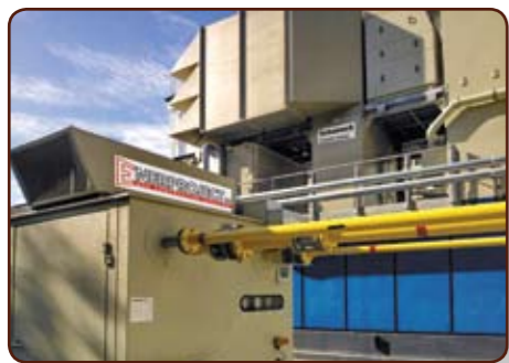
Рис. 5. Энергоцентр Минского КСИ – ГТУ Turbotach TBM-C40 мощностью 3,5 МВт и газокomppressorная установка Enerproject
