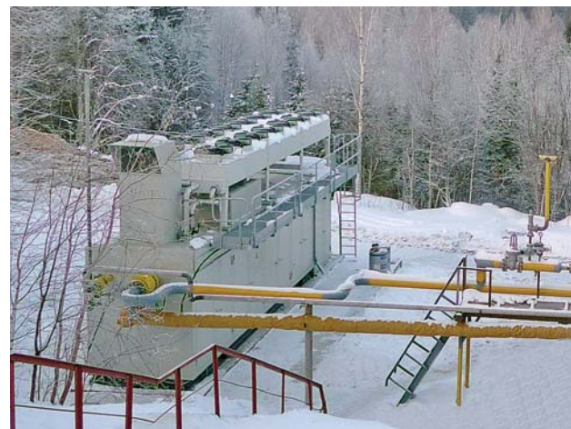
Фото 5. Дожимная компрессорная станция «ЭНЕРГАЗ» для стенда «Протон-ПМ»
