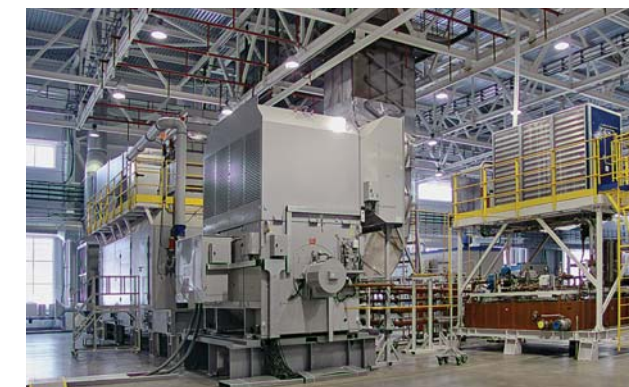
Фото 2. Испытания газотурбинной установки ГТА-16 на стенде «ОДК – Газовые турбины»
