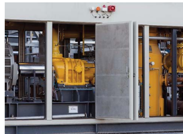
Фото 7. ДКС обеспечивает турбины газом с проектными параметрами по чистоте, давлению и температуре
