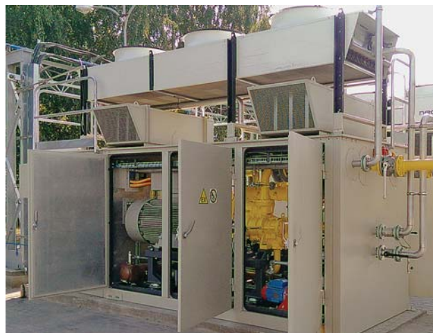
Фото 9. Компрессорная установка типа EGSI-S-55/350WA
