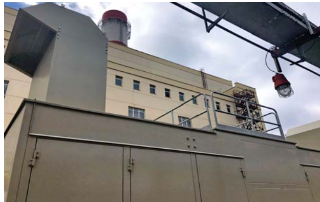
Фото 2. Новая ДКС топливного газа от компании ЭНЕРГАЗ
