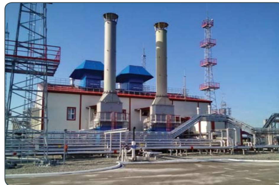
Южно-Нурьимское месторождение. Построенная в 2017 году ГТЭС собственных нужд «Сургутнефтегаза» работает на попутном газе
